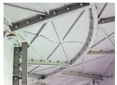
Scheuren in de gietijzeren vloerdelen.
